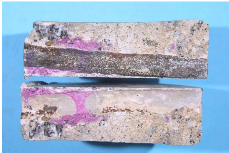
Figura 1.- Hormigón armado carbonatado. Manchas de corrosión en la zona de hormigón carbonatada (zona que no ha virado a coloración rosa). Foto cedida por el CEDEX.
