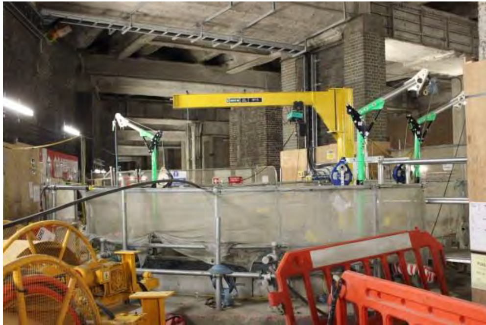
Figura 43. Pozo de compensación en interior de túneles
