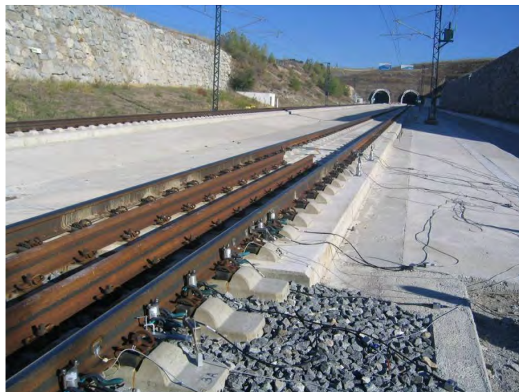
Foto 6. Instrumentación de transición vía en placa - vía sobre balasto
