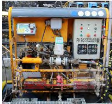
Figura 51. Bomba de inyección instrumentada y con control continuo de parámetros
