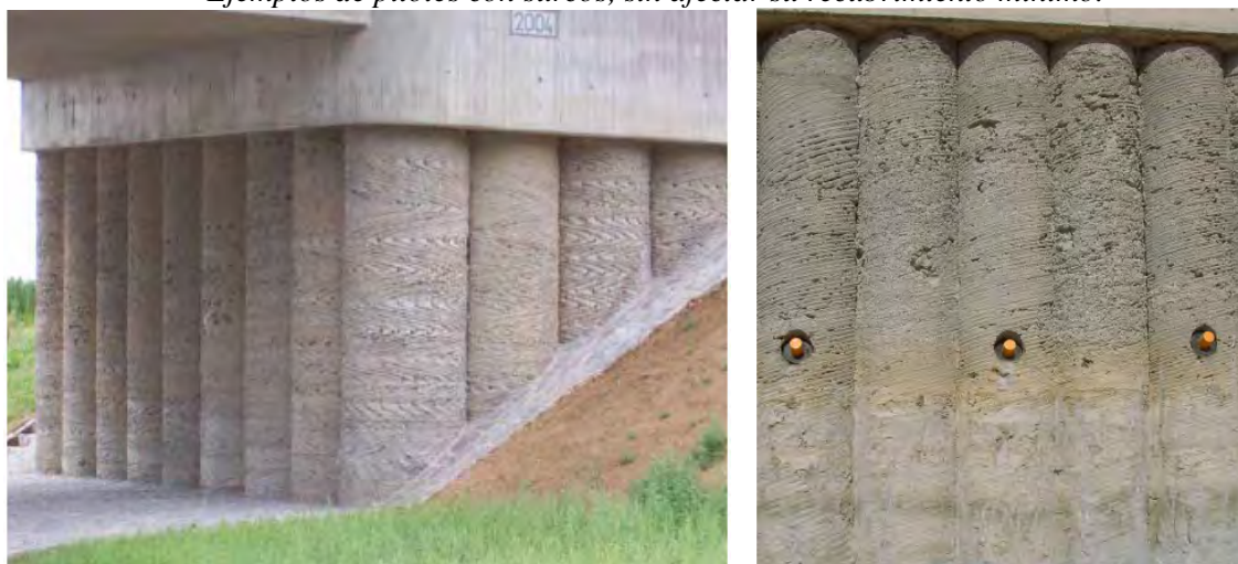
Ejemplos de pilotes con surcos, sin afectar su recubrimiento mínimo.
