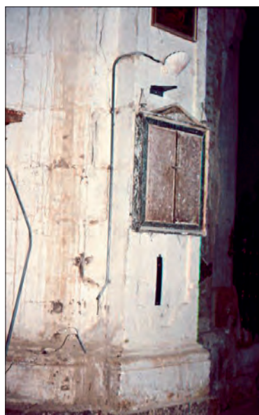
Figura 14. CONTROL DE INCLINACIONES POR LOS AUTORES EN LA IGLESIA DE SAN HIPÓLITO DE TÁMARA (Geocisa, 1983).
