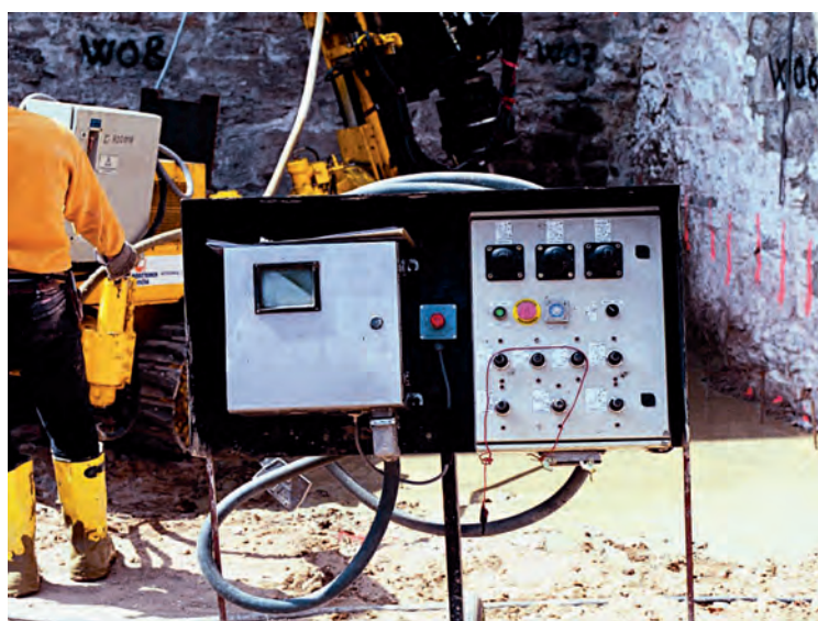
Figura 11. PANEL DE CONTROL DEL EQUIPO DE PERFORACIÓN Y SISTEMA DE REGISTRO DE PARÁMETROS.
