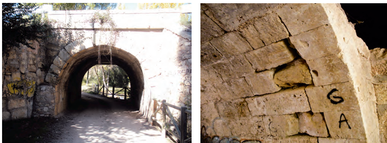
Figura 5. GRIETAS EN UN PONTÓN DE CARRETERAS. INTRADÓS DEL MISMO.
