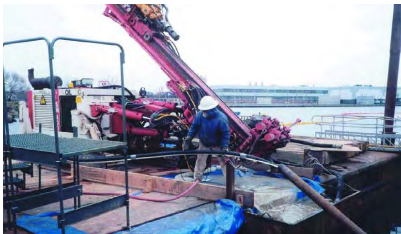
Figura 17. RECIPIENTES PARA CONTENCIÓN DE DETRITOS DE PERFORACIÓN (Nótese la barrera flotante el en fondo de la foto)
