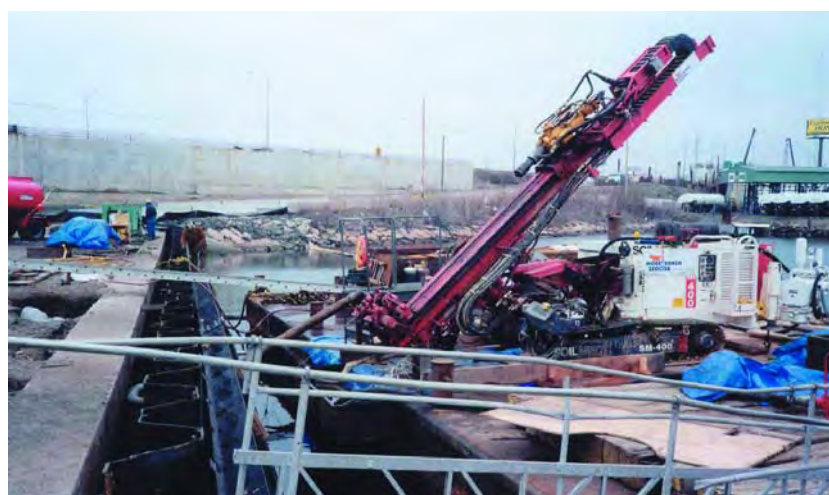
Figura18. VISTA GENERAL DE PONTONA CON SISTEMA PARA CONTENCIÓN DE DETRITOS (Nótese la barrera flotante el en fondo de la foto)
